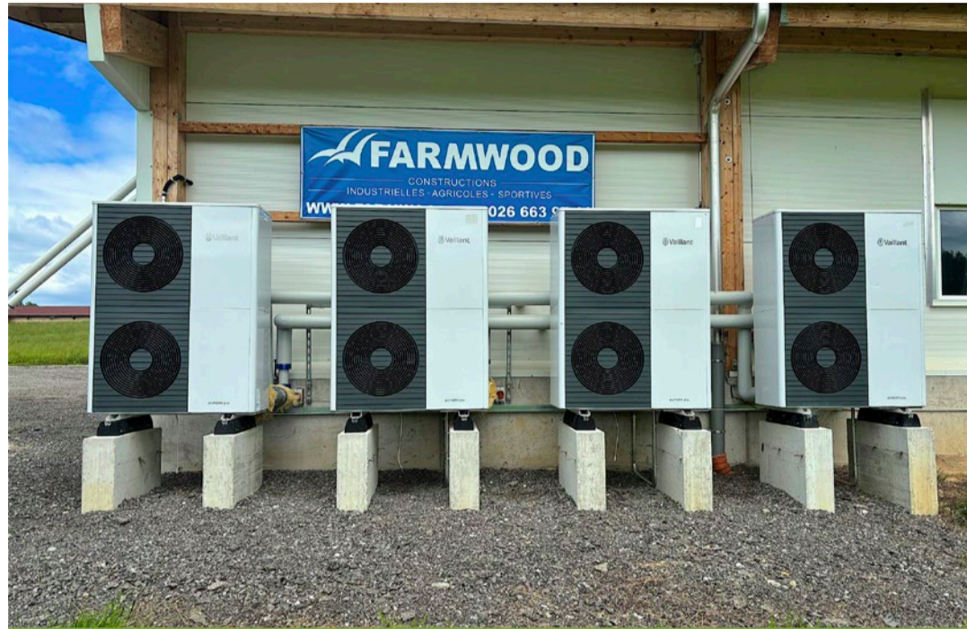
Au total, quatre pompes à chaleur de l'entreprise familiale allemande Vaillant sont montées sur le mur extérieur du poulailler. Selon les besoins en chaleur, plus ou moins de pompes fonctionnent.
