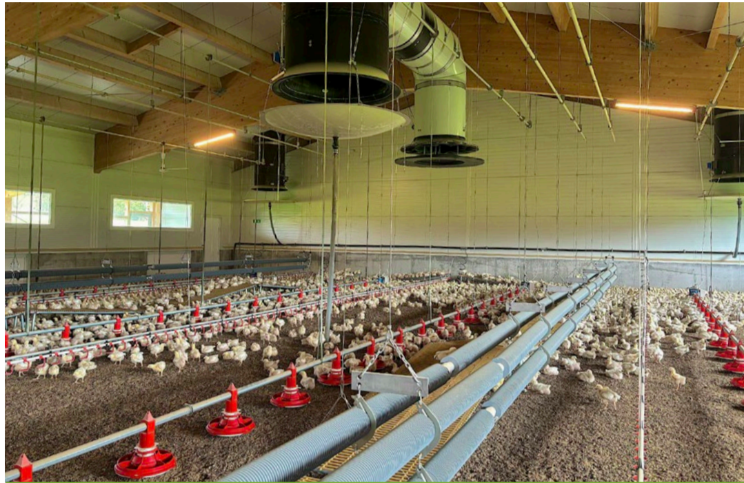
Grâce à la récupération de chaleur suspendue au plafond (gros module noir et blanc), l'air chaud évacué est dirigé vers l'extérieur par de nombreux petits tubes. L'air frais entrant est simultanément réchauffé.
